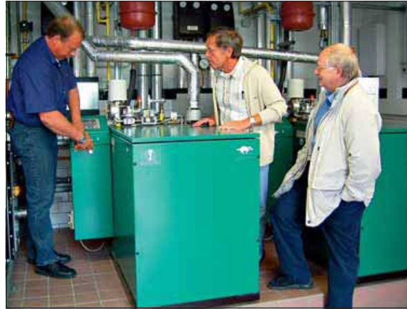
Durch die Sterling-Maschine im Blockheizkraftwerk ist die eigene Energieversorgung sicher gestellt. Fotos: B. Slupik
